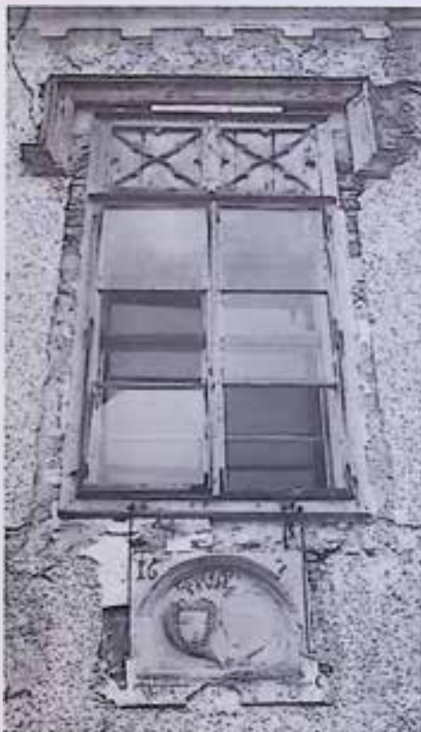
Dorff, Schloß, Westfassade, Schadensbild am Wappenstein des 17. Jhdts. und an der Fassadierung des romantischen Historismus. – Foto: BDA (Kerth)
