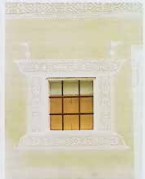
Steinbach a. d. Steyr, Zistlergut, nach Freilegung der Sgraffitodekoration. – Foto: T. Dimmel.
