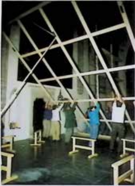
Aufrichten eines neuen Spannrahmens vor der Bildmontage in der Pfarrkirche Enns-Lorch. – Foto: BDA.
