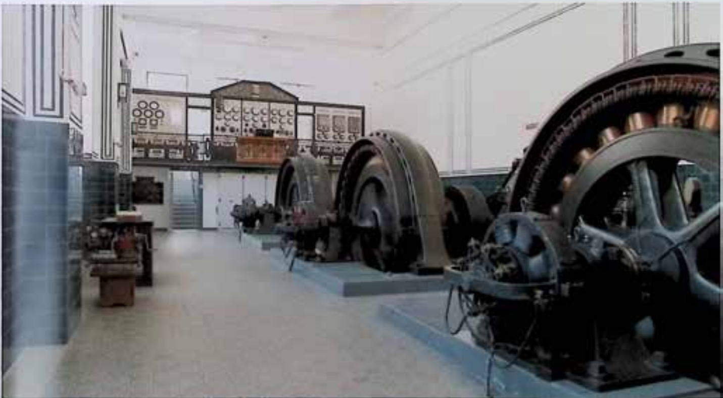
Kraftwerk Steyrdurchbruch, Turbinenraum, Foto: Endergie-AG
