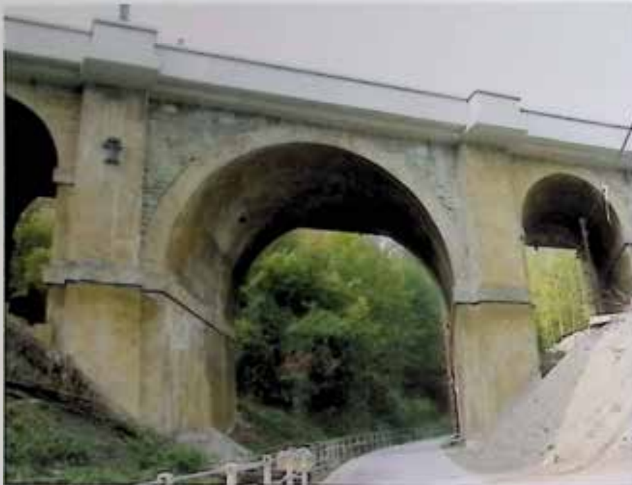
Semmeringbahn, Kübgrabenviadukt, „sanierte“ Parapetmauer
