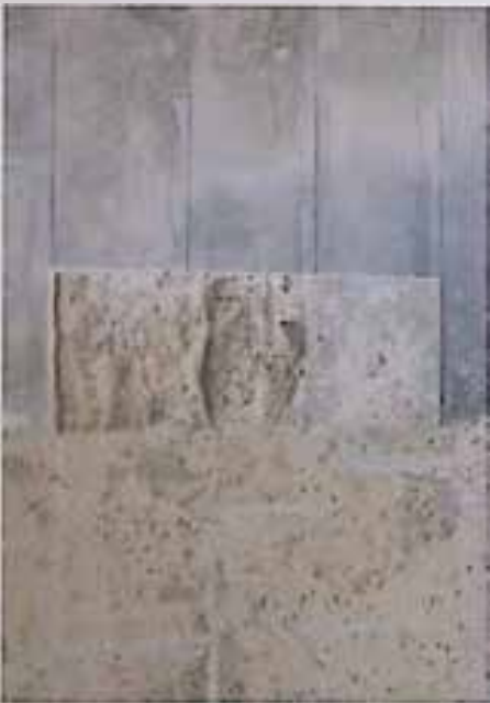
Maria Neustift, Pfarrkirche, Detail der Tuffsteinfassade vor, während und nach Restaurierung
