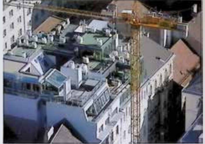
Wien, Wollzeile/Schulerstr, unter dem Begriff „Draufsetzen“ von der Stadt Wien propagierter Dachausbau in der Kernzone des Welterbes
